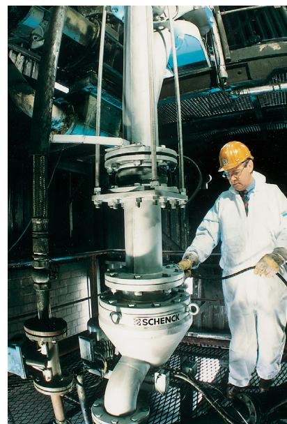
Type R-1 STENFLEX® installé dans une unité de dosage
